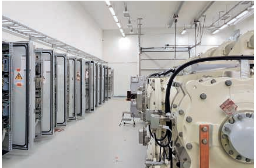
Uudet valvomorakennukset alkavat talotekniikaltaan ja energiatehokkuudeltaan muistuttaa jo omakotitaloja. Rakennusten varustuksena on wc, pienkeittiö, lämmitys, ilmanvaihto ja valaistus. Kuvassa on Ruotsinkylän sähköaseman valvomo. •
