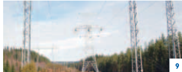
Kantaverkkoa vahvistetaan Keski-Suomessa.
