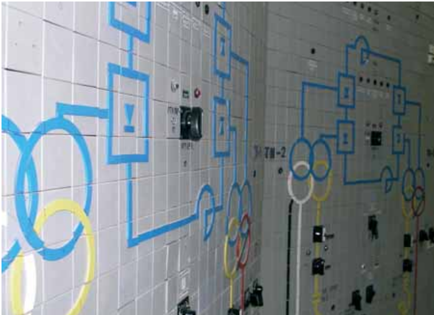
Osanäkymä Viipurin sähköaseman valvomon ohjaustaulusta.
