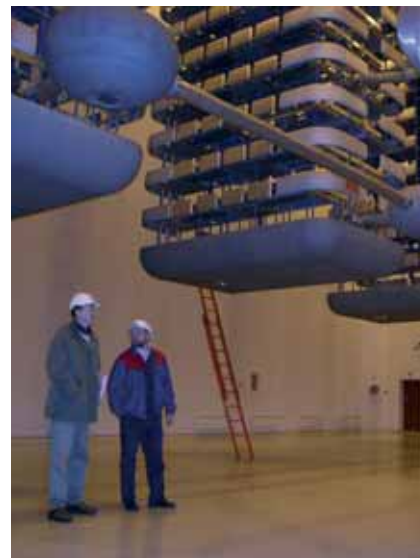
Rauman tasasähköaseman tyristorihalli. Kuvassa (vas.) Fingridin johtoreittiasiantuntija Hannu Ylönen ja suojausmestari Pekka Lepistö.
